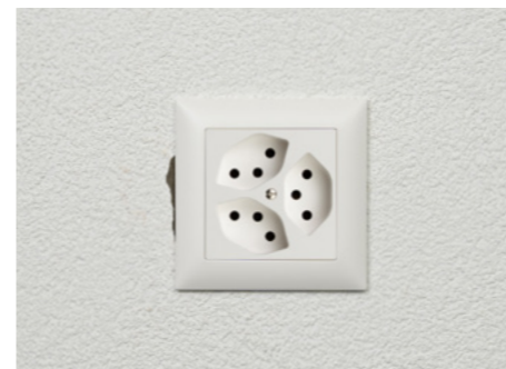
1. Il telaio di copertura EDIZIOdue (88 x 88 mm) non copre completamente la scatola ad incasso non installata in modo pulito.
