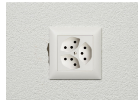
1. Le cadre de recouvrement EDIZIOdue (88 x 88 mm) ne recouvre pas entièrement la boîte d'encastrement mal installée.
