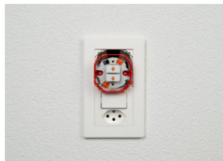
1. Au moment de la mise sous tension, vous constatez que les stores vont dans le mauvais sens.
